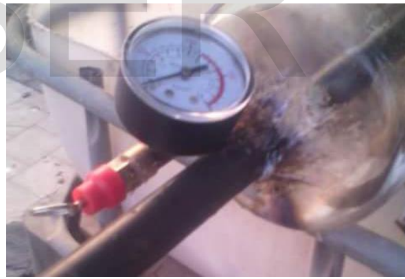
Fig.(10) PRV outlet
